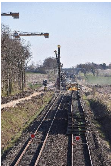
Kig fra vejbro i km 102,1, der skal reves ned, hen mod dæmningsarbejdet i km 102,5-102,7. I det fjerne ses vejbroen med Viaduktvej , hvor Rit eksisterede i den efterfølgende venstre kurve.
